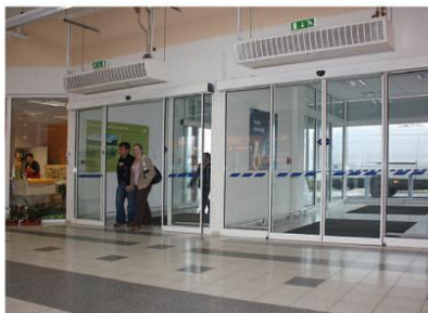
Zádveří s tepelnou clonou
