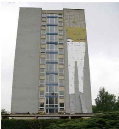
Klasická havárie zateplené fasády
