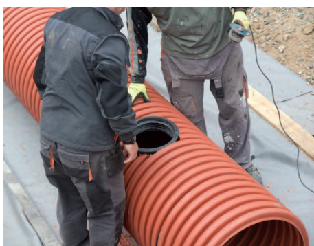
Ukázka nesprávné instalace: špatný technologický postup při navrtávání otvoru pro IN-SITU těsnění, do kterého má být vsazen vtok do šachty DN600. Těsnění vůbec netěsní, otvor je moc velký.
