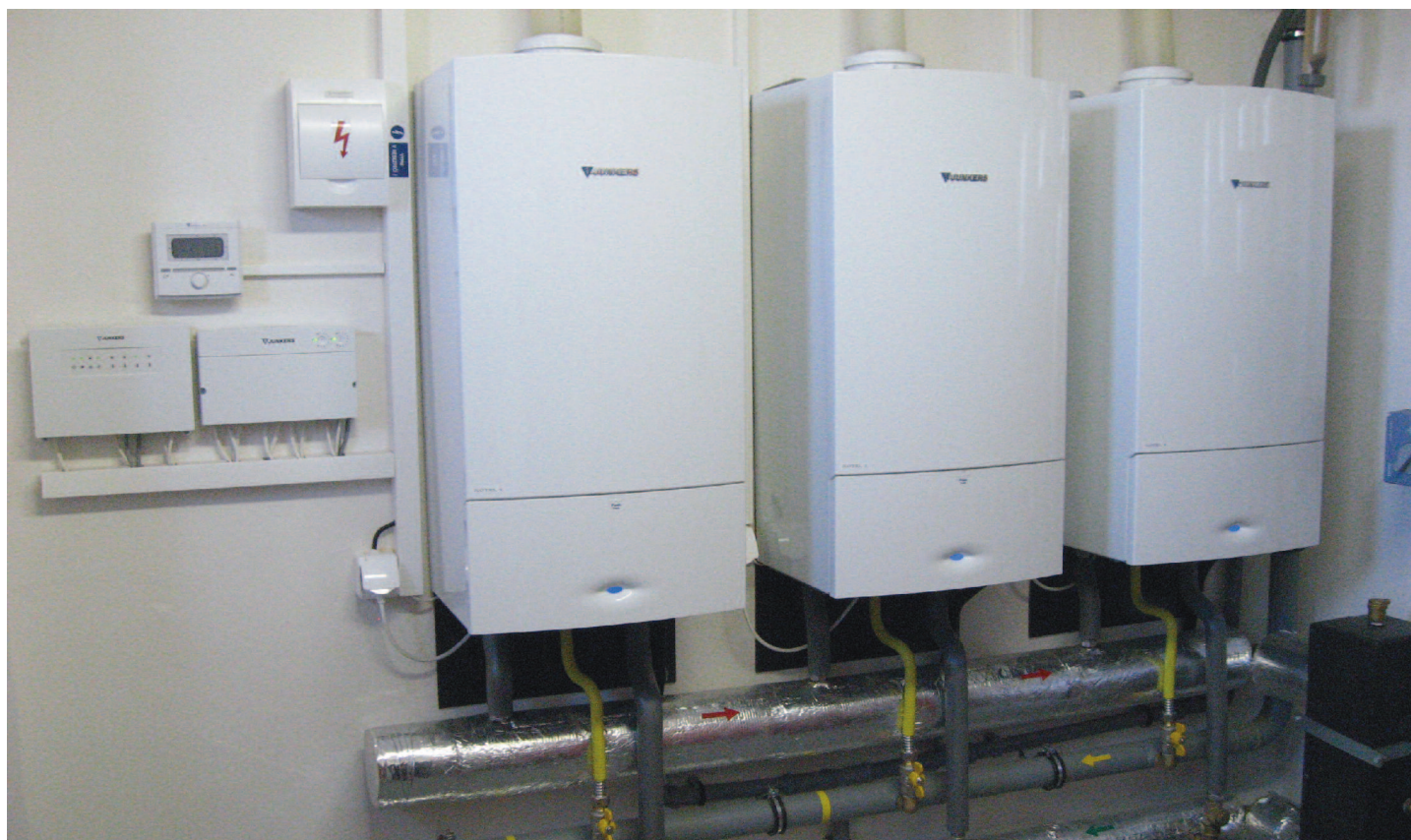
Obr. 3: Realizovaná kotelna v bytovém domě – kaskáda 3x ZBR42-3 A včetně regulace
