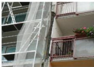
Obr. 4 – Odpadlá krycí vrstva v čele lodžiové stěny
