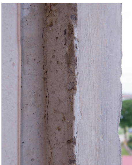
Stavební otvor musí být geometricky přesný a má dané tolerance
