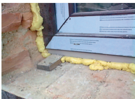
Obr. č. 1 Podkladní dřevěný špalek – okno bez parozábrany
