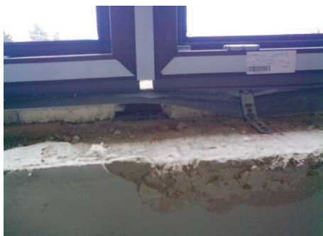
Obr. č. 4 Otvor v místě styku dvou rámu bez utěsnění
